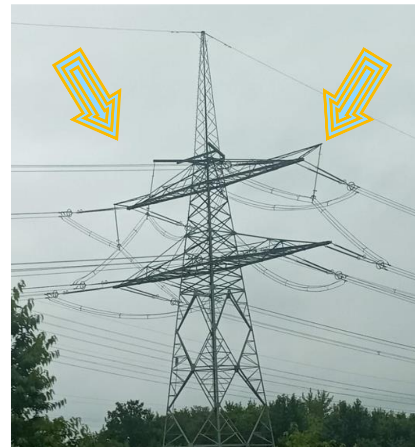
PRZEPLÓT WSZYSTKICH PRZEWODÓW
